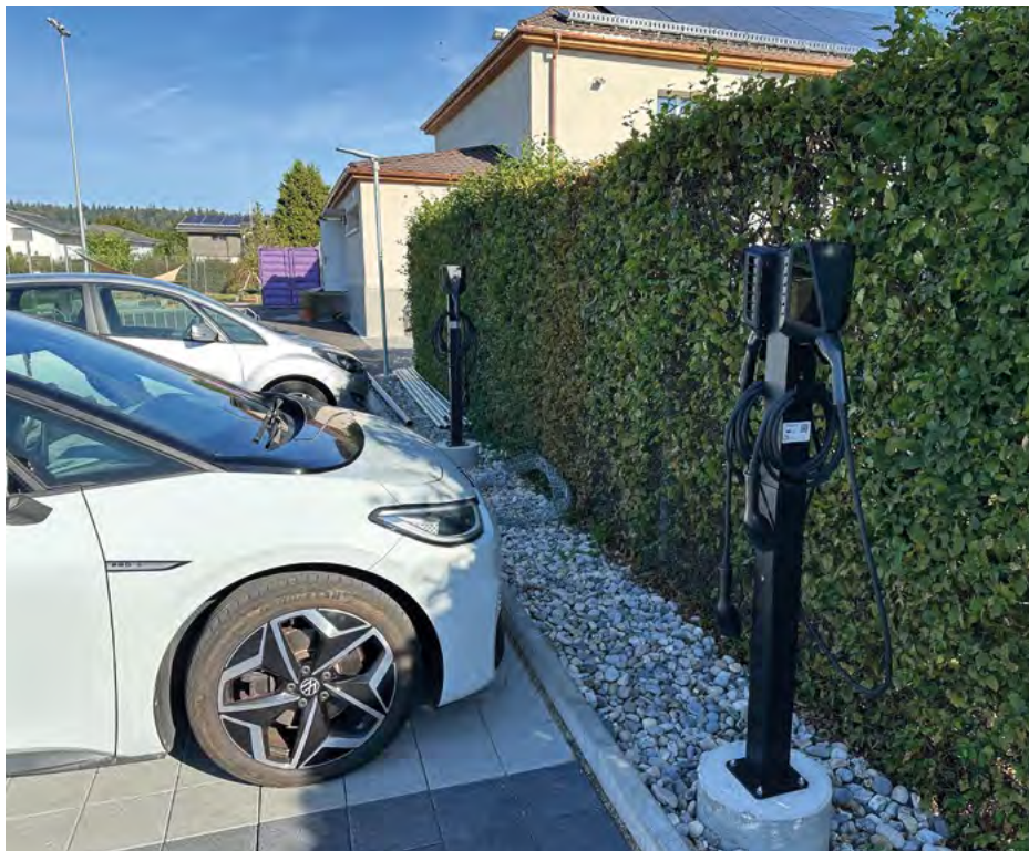
Zwei der vier öffentlichen Ladestationen für Elektrofahrzeuge bei der Turnhalle Bündtenacker
